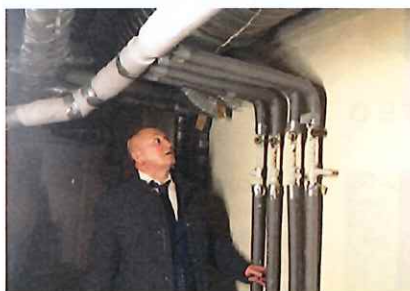
Депутат Александр Тозик на приемке работ по капитальному ремонту дома по адресу: мкр. Северное Чертаново, д. 4
